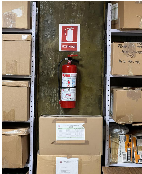
Colocación de extintores en áreas diversas.
